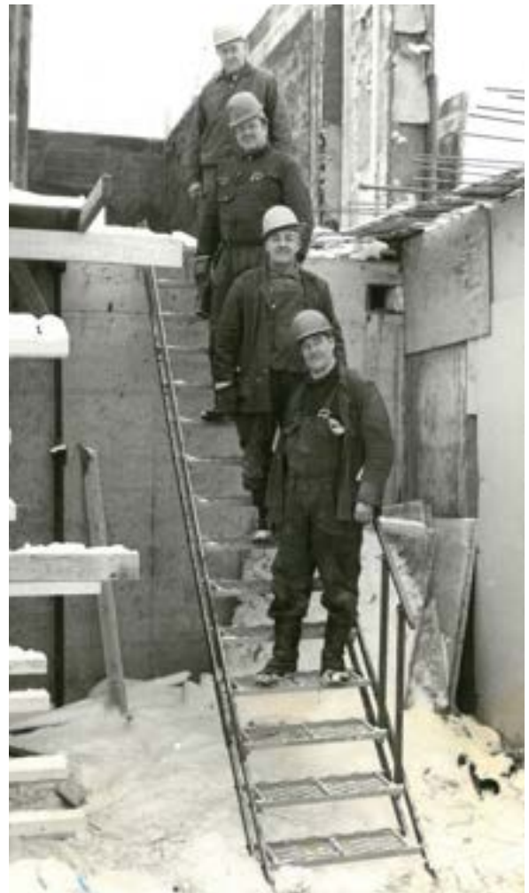
Bilden visar arbetare på den första 15 stegs trappan som användes vid byggnationen av sim- och sporthallen i trappans hemort Edsbyn.
